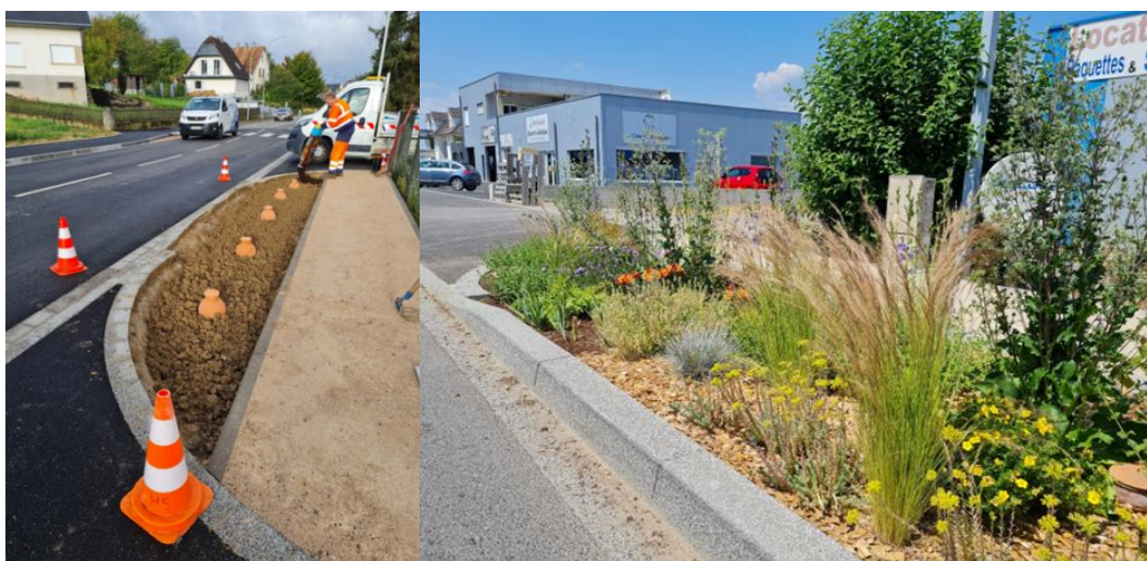
Exemple d'aménagement d'un massif à Hirsingue
